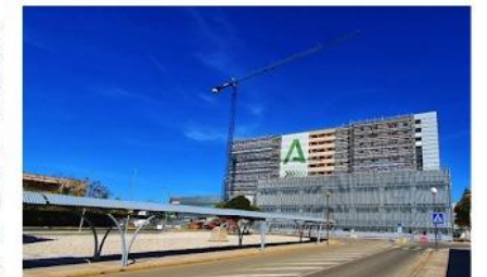
Fachada principal del edificio en rehabilitación del antiguo Hospital Militar de Sevilla.
